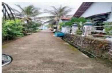
Gambar 4-78 Kondisi Saluran Drainase
