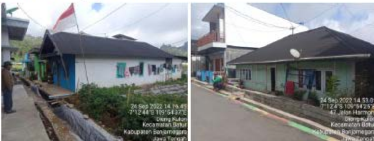
Gambar 4-73 Kondisi Saluran Drainase
