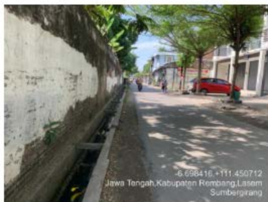
Gambar 4-7 Kondisi Saluran Drainase
